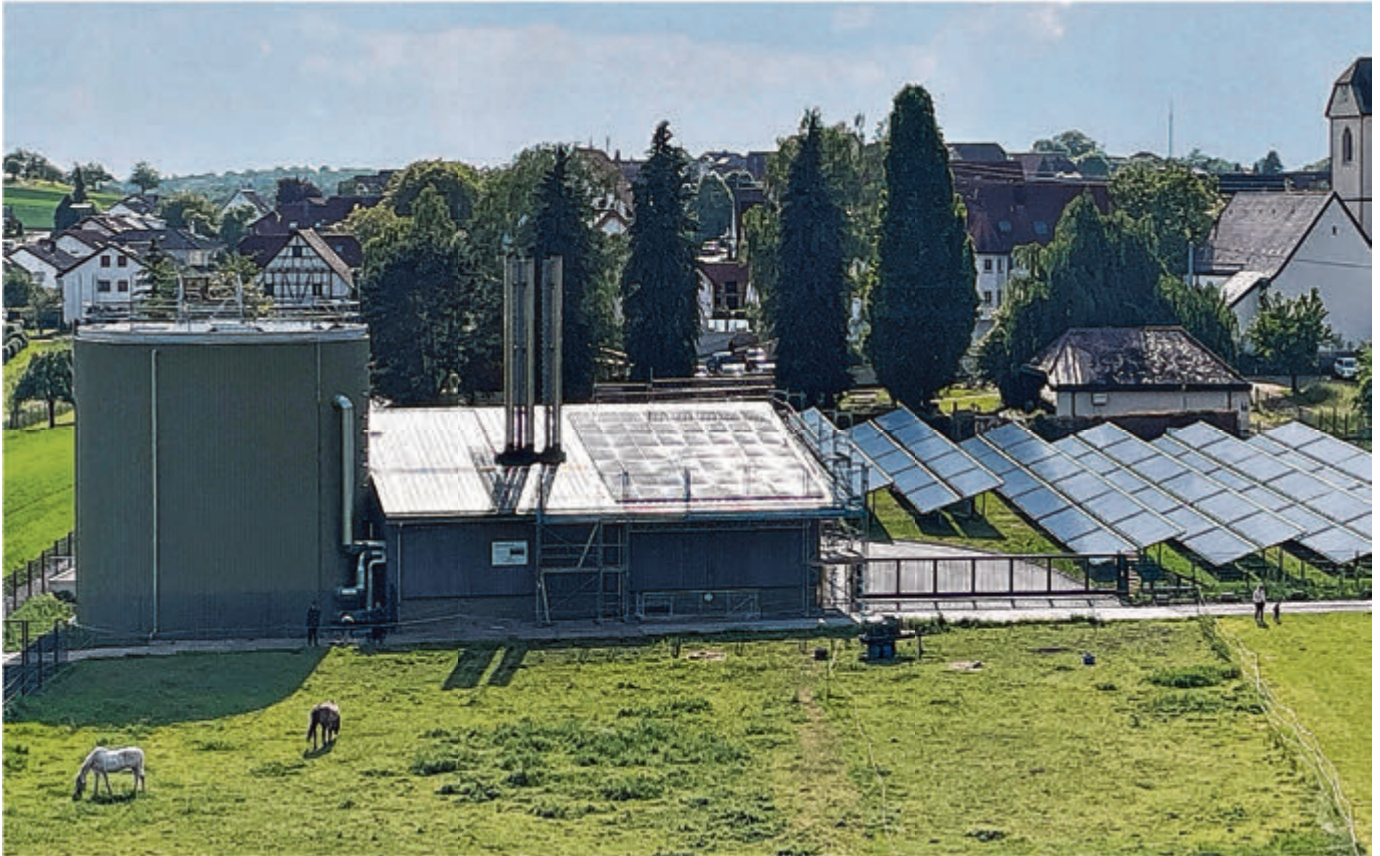
Die Heizzentrale versorgt das Bioenergie Dorf Breitenholz mit nachhaltig erzeugter Nahwärme.
